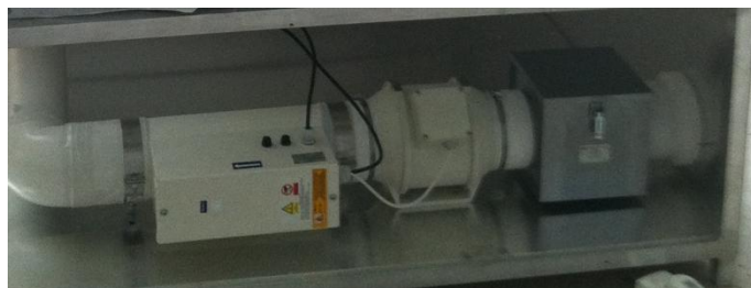
Układ nawiewu powietrza filtr, wentylator, nagrzewnica
